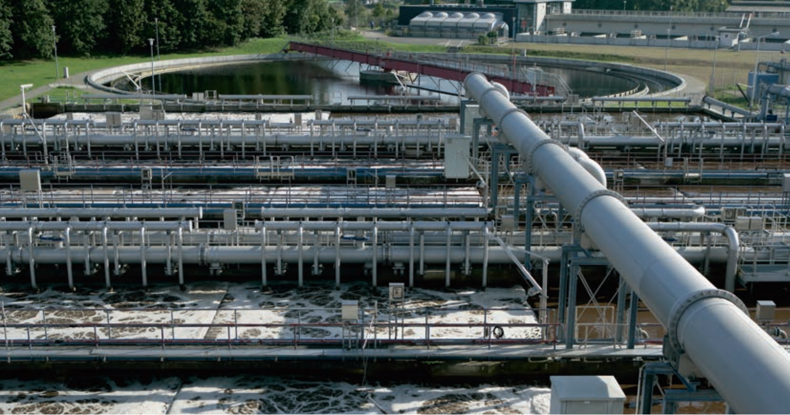
下水処理場における曝気制御のための溶存酸素測定
