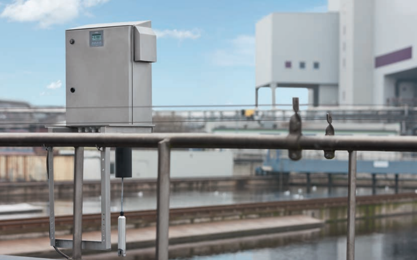
スラッジブランケット測定：ドイツ・クレーフェルト 廃水処理場 Secondary clarifier
